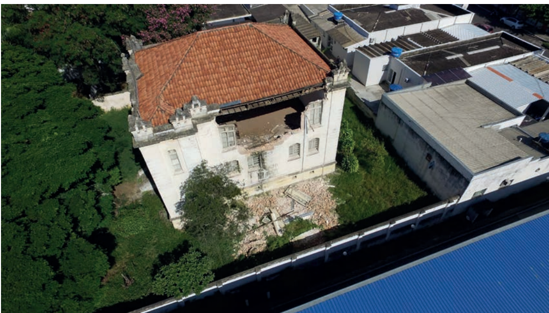
De cima, é possível ver o tamanho do estrago e também o abandono do prédio (Foto: Tonny Machado)
