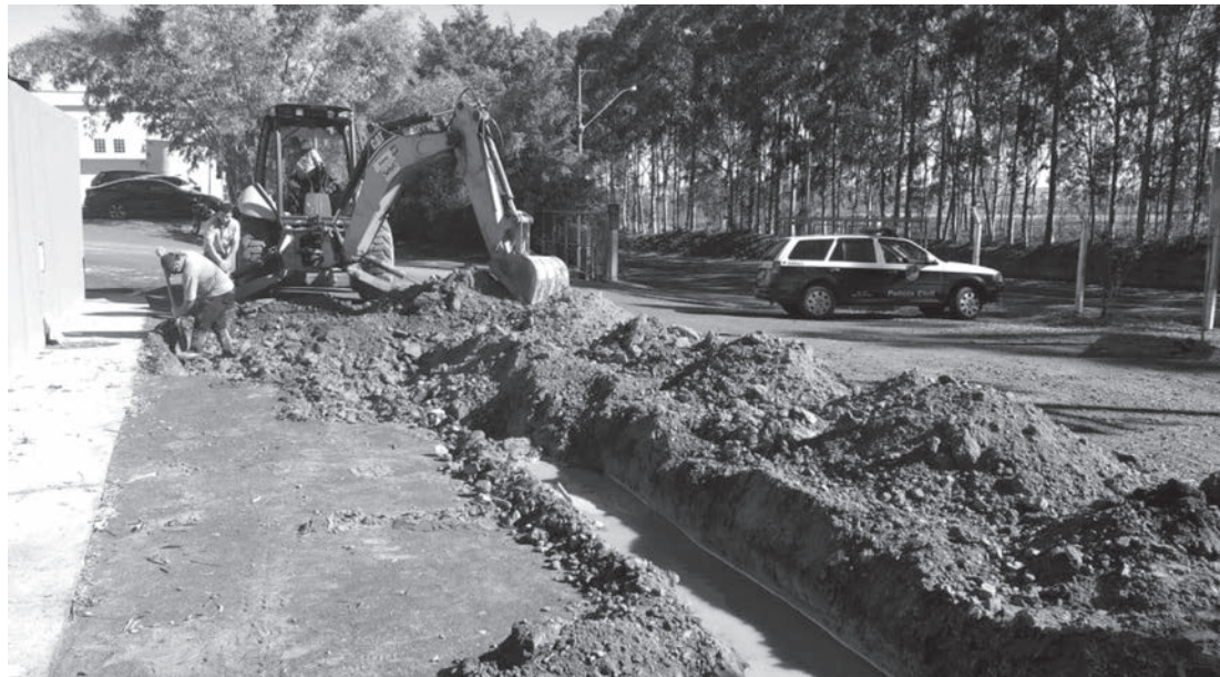
Máquina escavou pátio da empresa e encontrou rede clandestina (Foto: Divulgação/Polícia Civil de Capivari)
