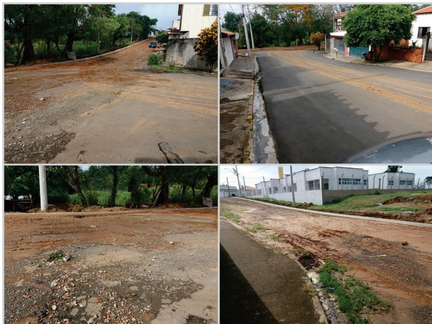
Morador registrou situação e cobrou providências do poder público; obra deveria ser finalizada em novembro de 2020 (Fotos enviada pelo leitor)
