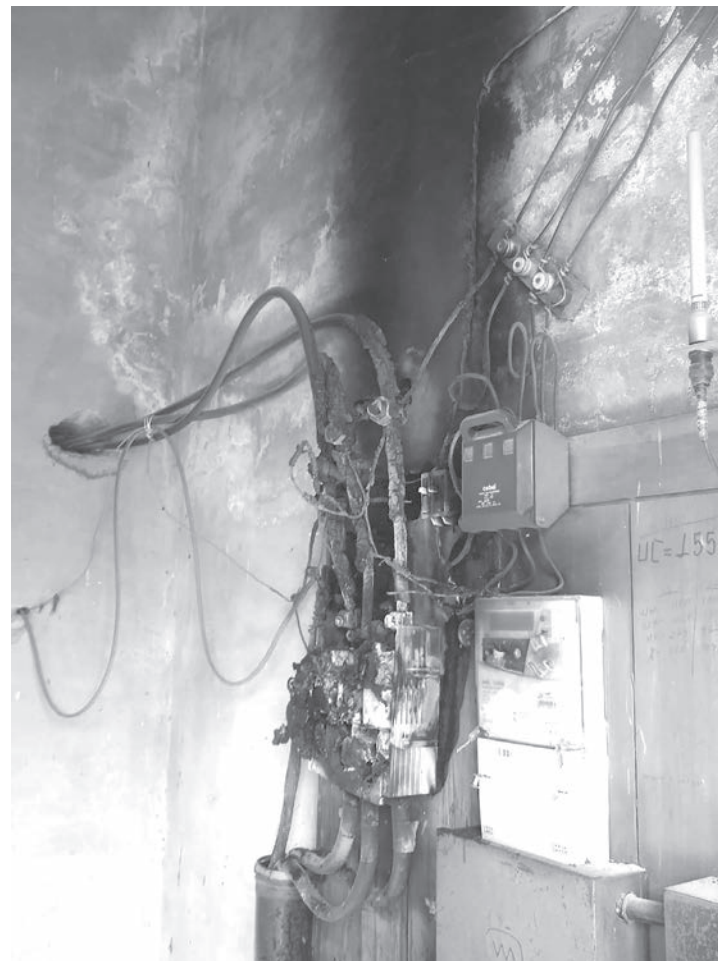
Painel foi totalmente danificado pelo fogo (Foto: Divulgação/Prefeitura de Rafard)
