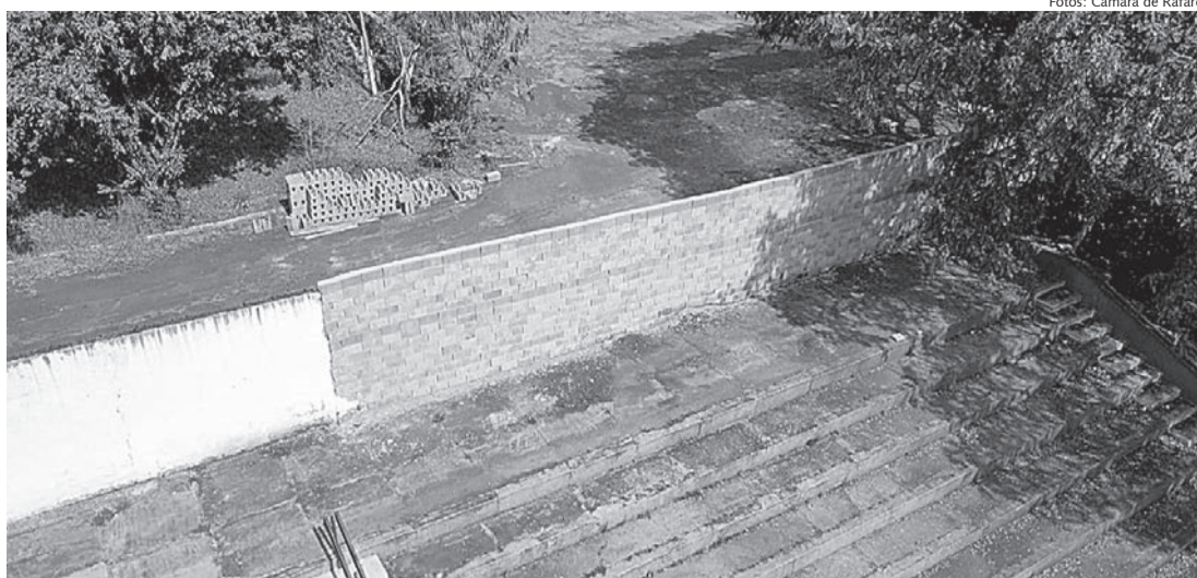
Depois de queda, muro da arquibancada foi reconstruído, mas apresenta condições precárias
